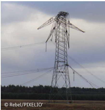
Sturmschaden durch den Orkan Kyrill im Jahr 2007
